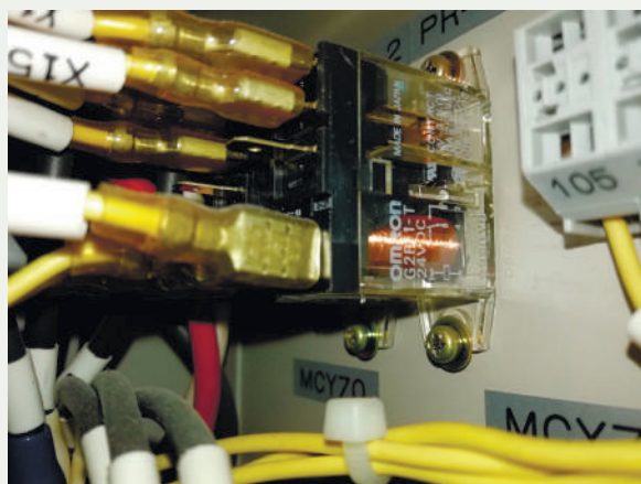
Данное реле omron исправно работает даже спустя 35 лет после установки!
